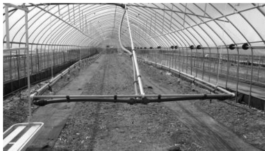
【저상스프링쿨러(수직이동식) 설치 전경】
